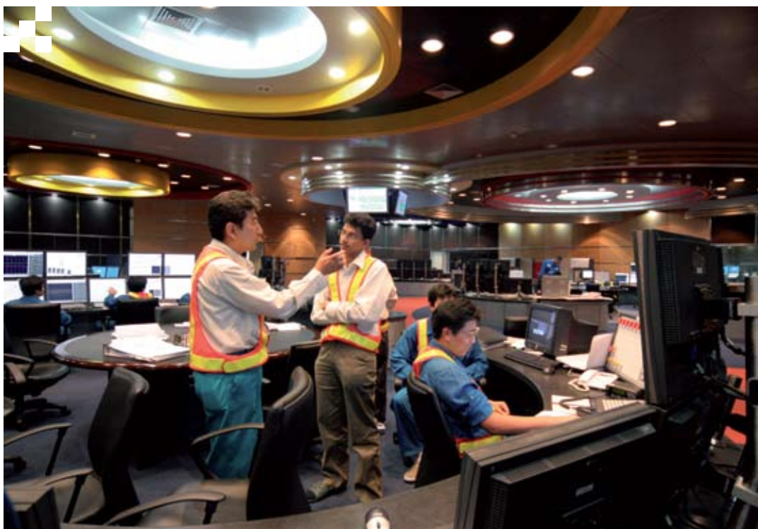
Una de las Salas de Control
